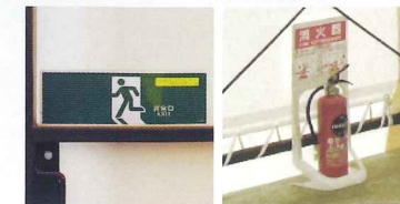
避難誘導標識
